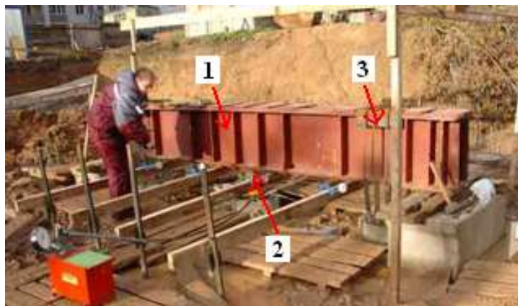
Рис. 2.1. Фотография испытания грунтов сваей вертикальной статической нагрузкой с использованием металлической балки и анкерных свай. 1- металлическая балка, 2- гидравлический домкрат, 3- крепление анкерных свай.
