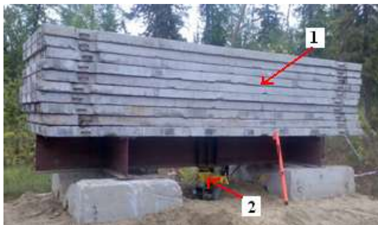
Рис. 2.2. Фотография испытания грунтов сваей вертикальной статической нагрузкой с использованием пригрузочной платформы. 1 – пригрузочная платформа, 2 – домкрат для передачи нагрузки на испытываемую сваю.
