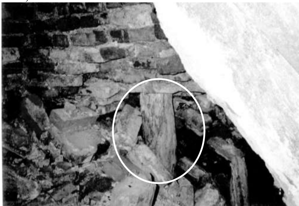
Рис. 1.9. Разрушение кирпичной кладки стен погребов в результате гниения голов деревянных свай
