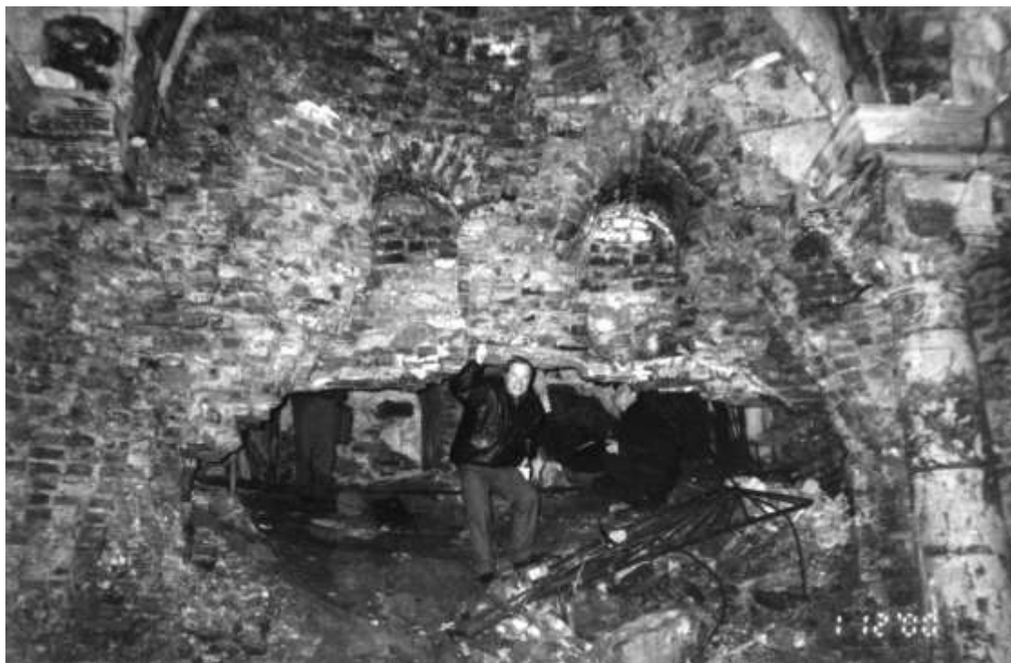
Рис. 1.11. Обрушение подпорной стены с образованием проемов высотой до 1,5 м
