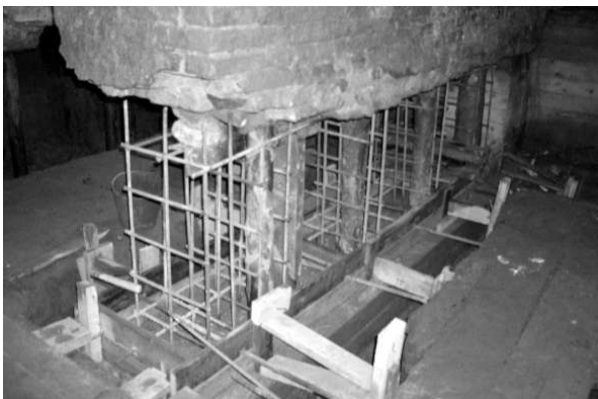
Рис. 1.15. Подготовка к бетонированию ростверка под поперечные стены в погребках террасы дворца. Стены террасы вывешены на буроинъекционных сваях
