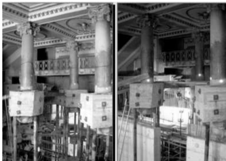
Рис. 1.6. Вид на подпорные микросваи кирпичных колонн основного входа во время проведения откопки и устройства новых подземных конструкций
